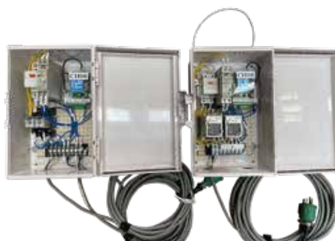
ワイヤレスフロート制御盤
