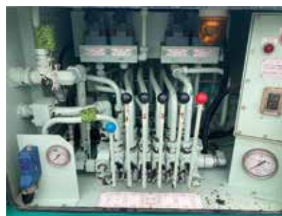
ユニット内部
