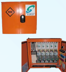
④操作盤・分電盤
